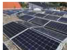
Photovoltaikanlage auf dem Dach
